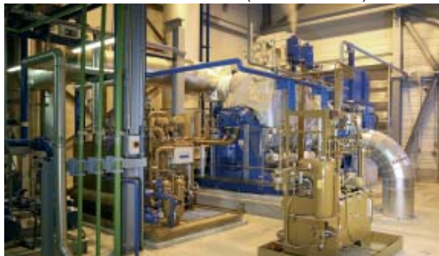
Ein Blick in das Innere des Kraftwerks (Quelle: BHI GmbH)
