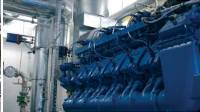
Ein Teil des BHKW (Quelle: BioWerk Hamburg)
