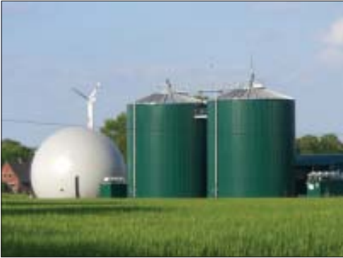
Die Biogasanlage in Hollich (Quelle: S. Nefigmann)
