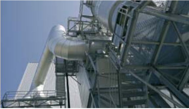
Das Biomasseheizkraftwerk (Quelle: BHI GmbH)
