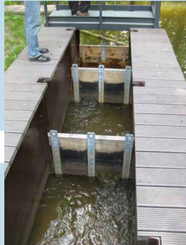
Fischaufstiegsanlage – für die Zugabe geringer Wassermengen als Schlupflochpass gestaltet
