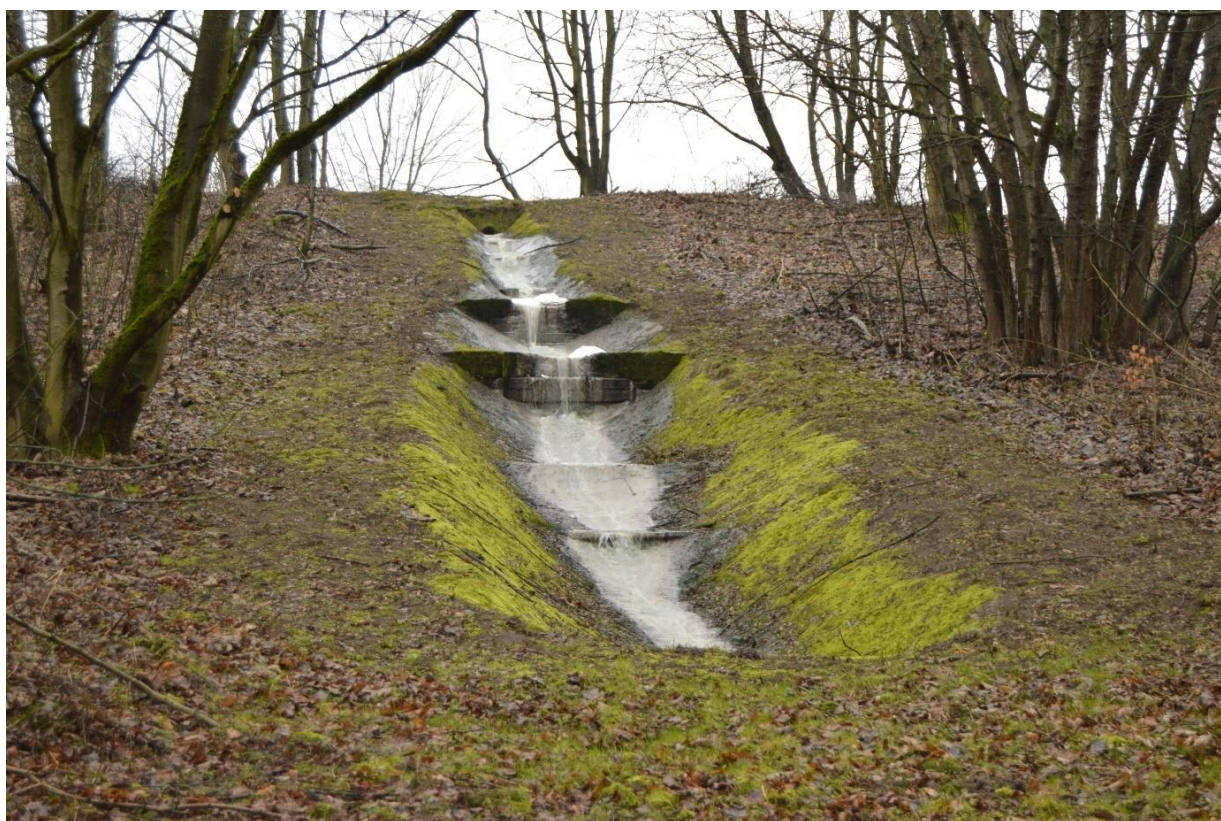
Fot. 13. Spływ nieoczyszczonych ścieków z oczyszczalni w Mostach (fot. J. Krzystolik).
