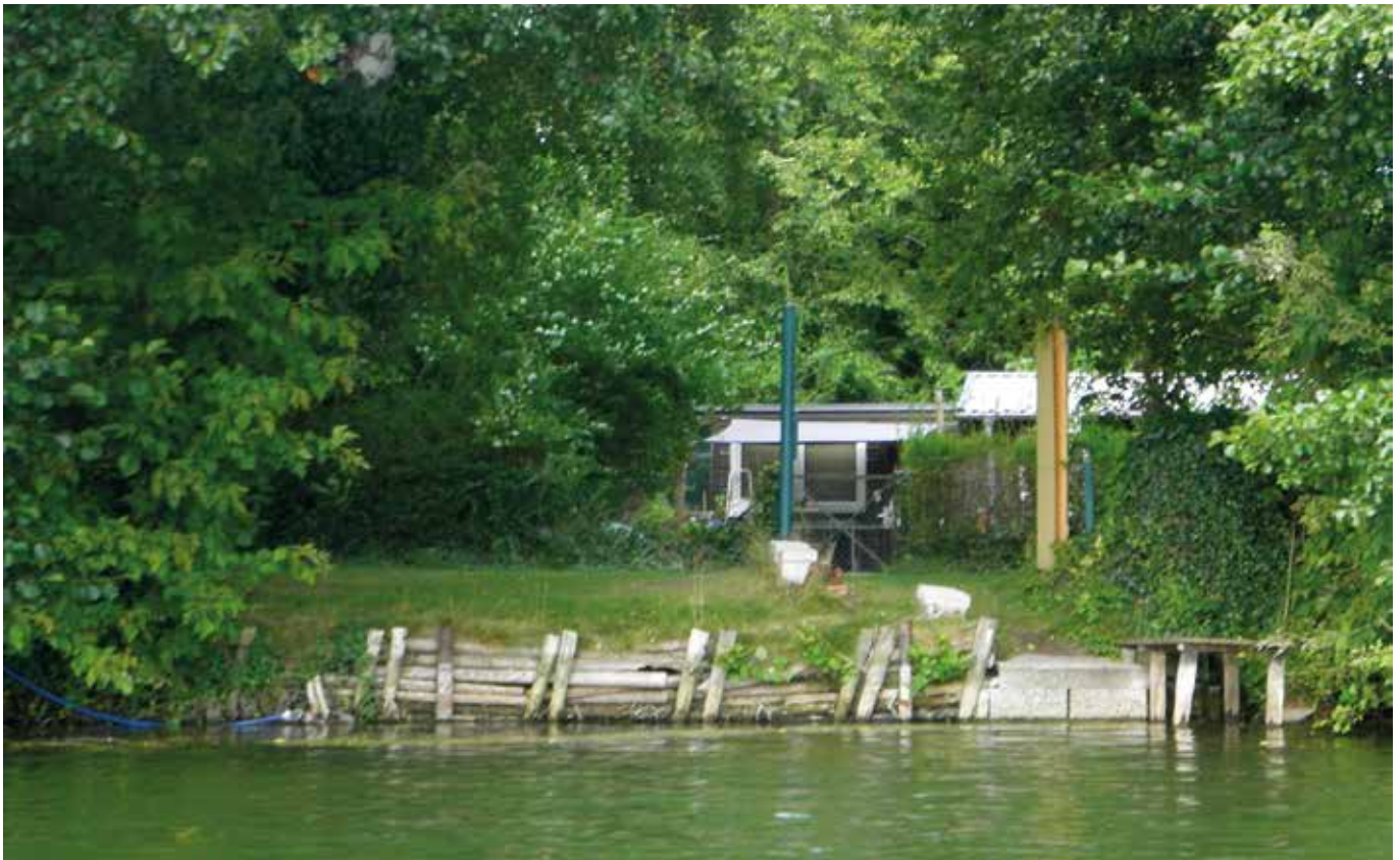
Barrierewirkung durch senkrechte Uferbefestigung mit Holzpflocken – hier besteht Handlungsbedarf, Landschaft planen + bauen
