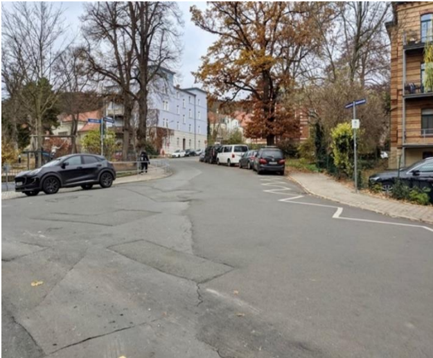
Abb. 68: Breiter Straßenquerschnitt und Unebenheiten auf Fahrbahndecke (Semmelweisstraße) (Foto: © ISP der FH Erfurt, 2021)
