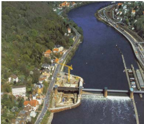
Wasserkraftwerk am Karlstor Foto: Umweltamt Heidelberg
