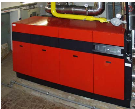
Im Rahmen des Hamburger Kessel-tauschprogramms werden alte Heizkessel durch neue Brennwertkessel ersetzt. Foto: Ronald Burchardt
