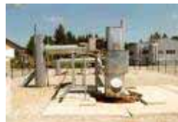
Simbach/Braunau 35,8 MW th
