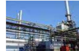
Castrop-Rauxel 95 t/h / 13,4 MW el
