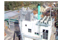
Buchenbach 3,3 MW th / 1,2 MW el
