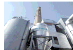
Neufahrn 10 MW th / 5,1 MW el
