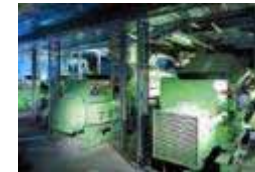
Fenne 42 MW th / 42 MW el
