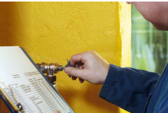
Abb. 2: Thermostatventil wird eingestellt; ©CO2online
