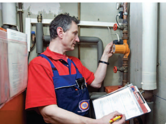
Abb. 2: Messungen an der Heizungspumpe © ZVSHK
