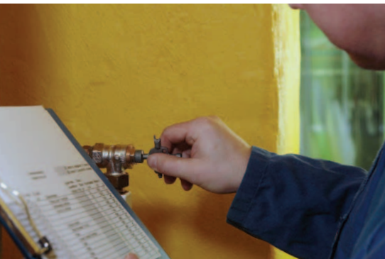
Abb. 2: Thermostatventil wird eingestellt; © CO2online
