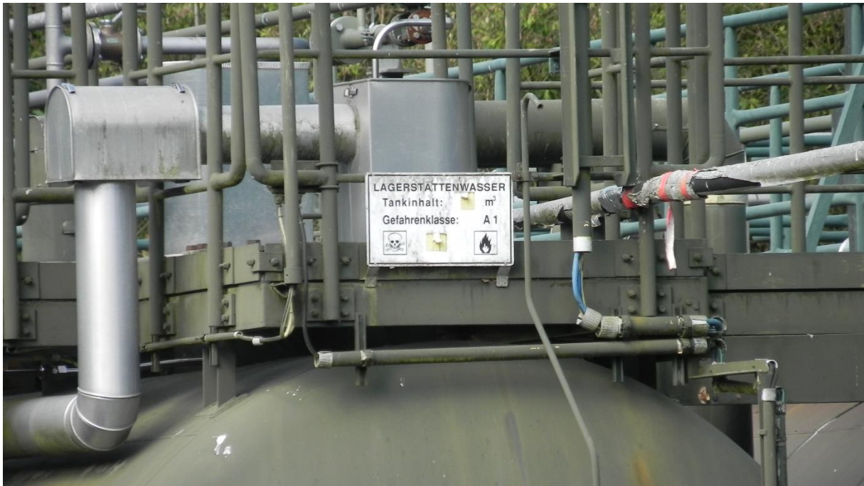
Foto: Lagerung von umwelt- und wassergefährdetem Produktionswasser/Lagerstättenwasser aus niedersächsischen Rotliegend-Erdgaslagerstätten
