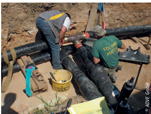
Fünf Wärmenetze der AOVE Energiegenossenschaften versorgen mehr als 250 Haushalte mit Wärme aus erneuerbaren Energien
