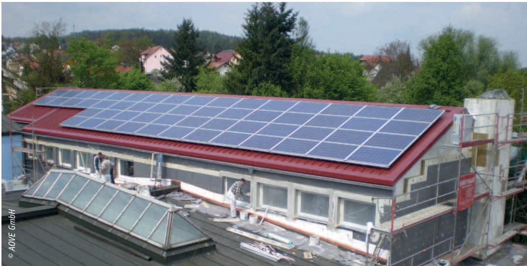
Photovoltaik-Anlage der AOVE-Bürger- sonnenkraftwerke GmbH
