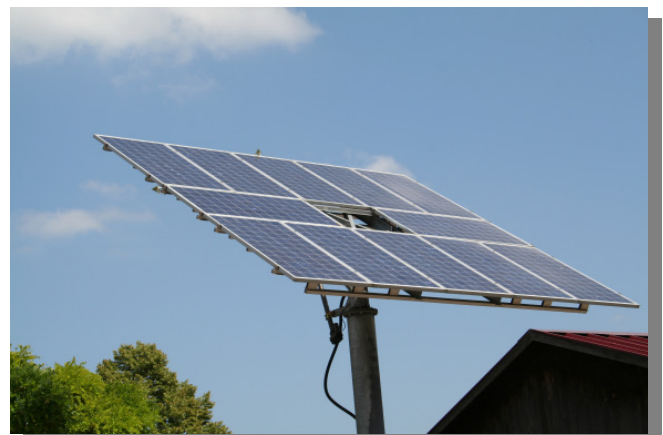
Nachgeführte PV-Anlage in Wiernsheim
