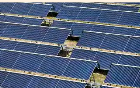
Freifeld-Kollektoranlage im Betrieb
