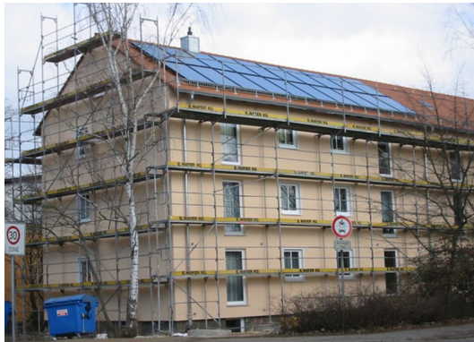
Energetische Sanierung mit Solarwärmanlage hilft dem Klimaschutz © GEWOBAU-Erlangen
